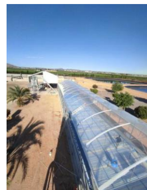
Planta de secado solar
