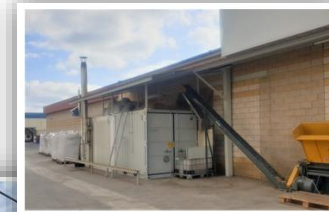
Contenedor: de palet a calor
