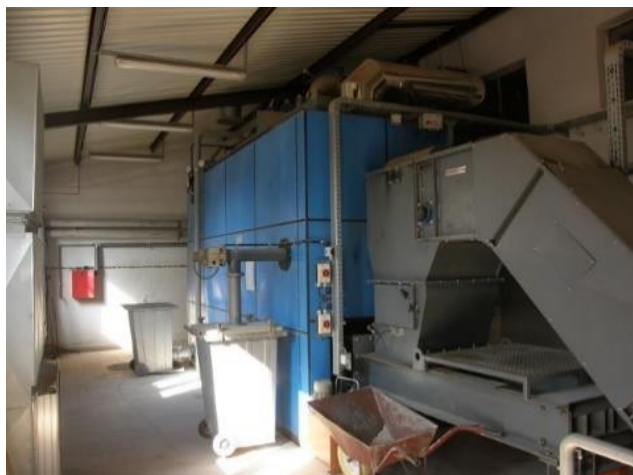
Interior de las plantas de calefacción térmica sustituidas por calderas de biomasa
